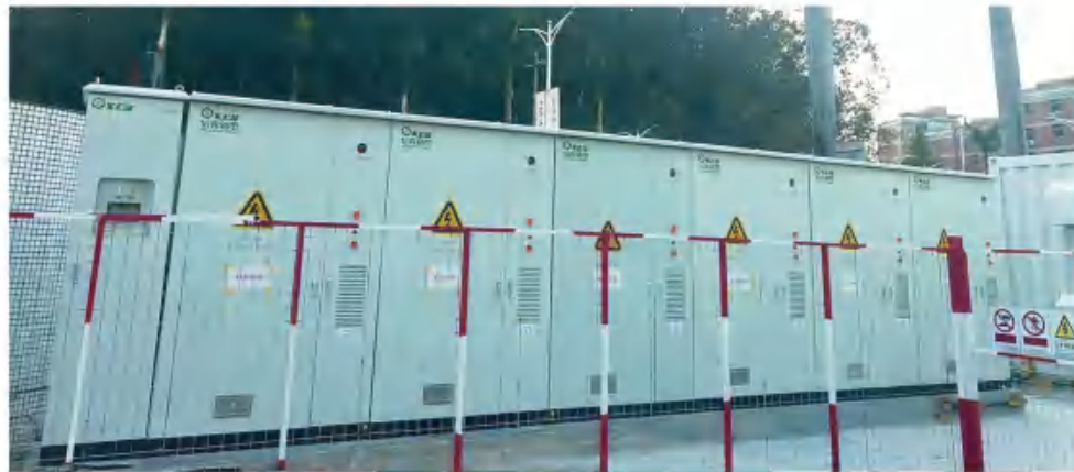
深圳横岗储能项目
