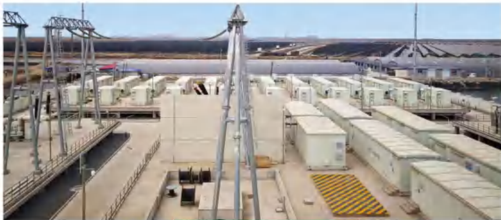
华润曹妃甸储能电站
