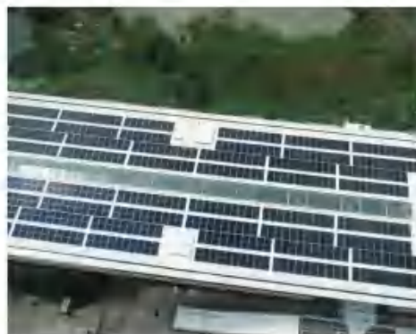
安徽芜湖轻轨交通车站屋顶光伏项目
