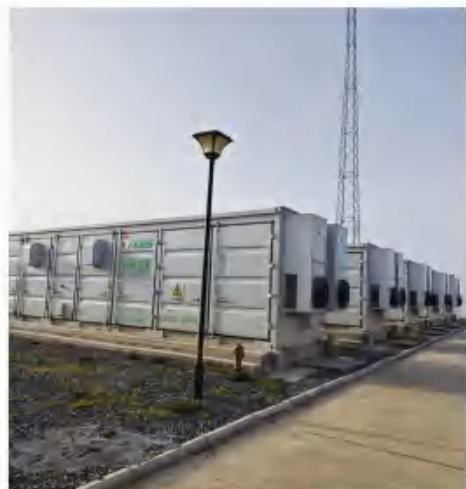
湖北安陆独立（共享） 储能电站
