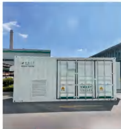
中电兴发储能项目
