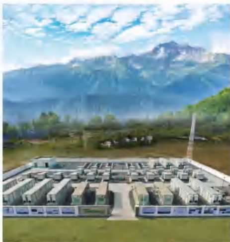
湖北老河口储能电站
